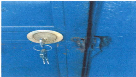
FOTO 3: Sustrucción de chapas
